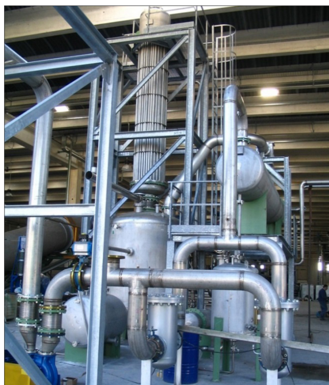
Fig. 5 - Impianto di condensazione del pyrogas
