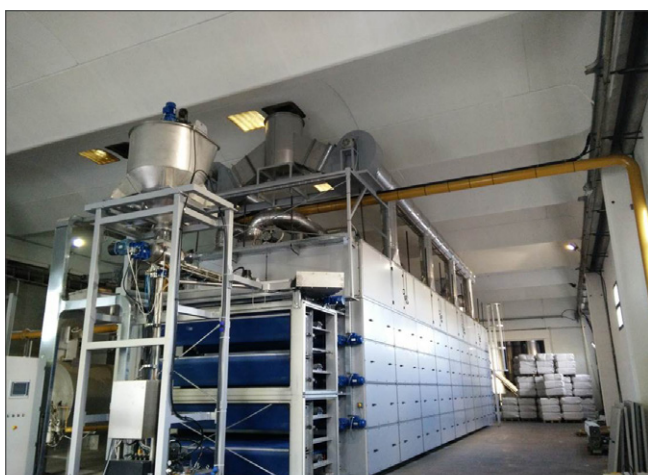
Fig. 1 - Installazione di un impianto di essiccazione a bassa temperatura e basso consumo energetico
