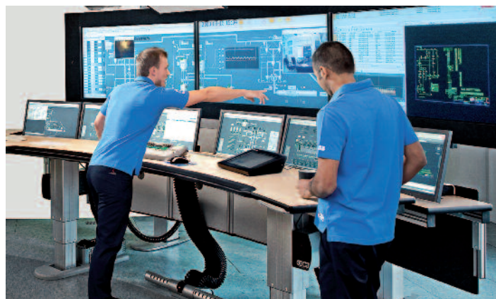
Sala di controllo nel Technology Centre Mongstad con console EOW-X di ABB
