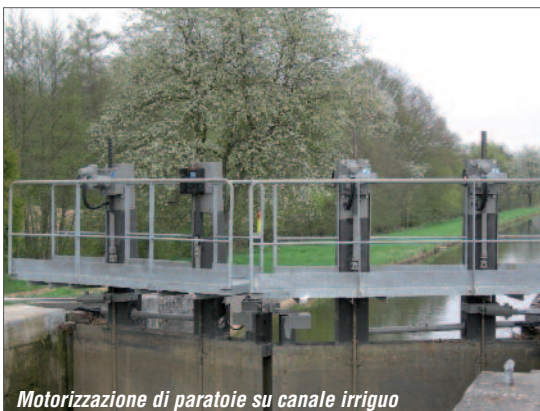
Motorizzazione di paratoie su canale irriguo
