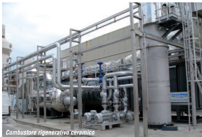
Combustore termico rigenerativo con sfati concentrati inviati direttamente in camera di combustione mediante elettore a vapore
