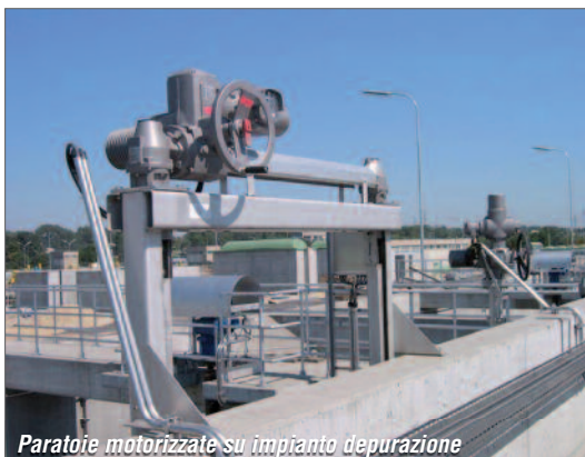
Paratoie motorizzate su impianto depurazione
